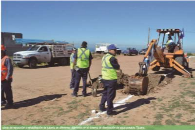
Obra de reparación y rehabilitación de tuberías de drenaje, dentro del sistema de distribución de agua potable, Tijuana.
